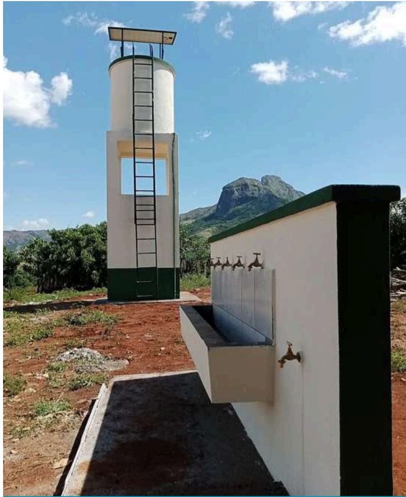
Lave main et château d'eau
